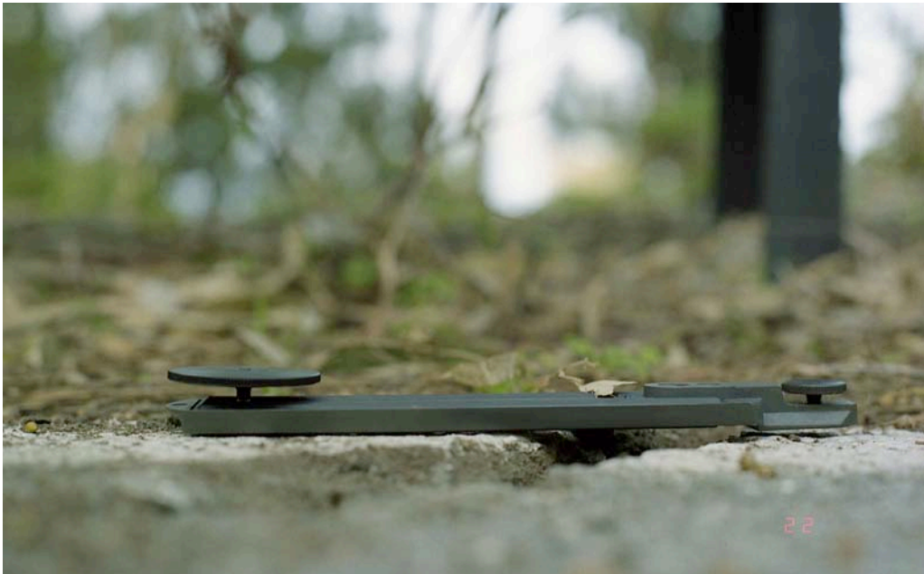
Figura 4. Hundimiento cercano a los cinco milímetros del bloque oriental de la falla de la figura 3. (la fotografía está tomada hacia el norte)
