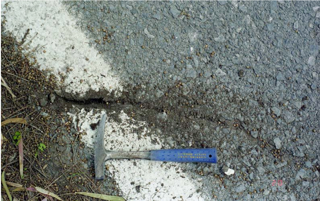
Figura 3. Grieta en la carretera de Bezú-García Aldave a su paso por las cercanías del chalé La Ponderosa, causada por la falla 4 del "Esquema tectónico..."
