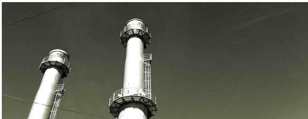
Central térmica de Endesa, Ceuta
