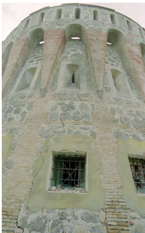
Figura 1. Grietas en la cara norte del fortín de Aranguren
