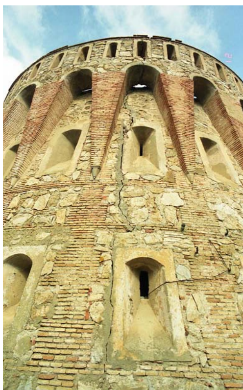
Figura 2. Grietas en la cara sur del fortín de Aranguren
